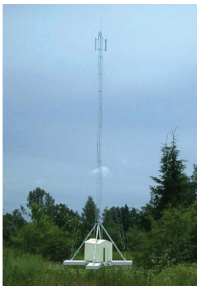
Bāzes stacija. Baltajā ēkā pie antenas torņa atrodas raidītāji un uztvērēji. Savienojumam ar centrāli izmanto radiosakarus.
